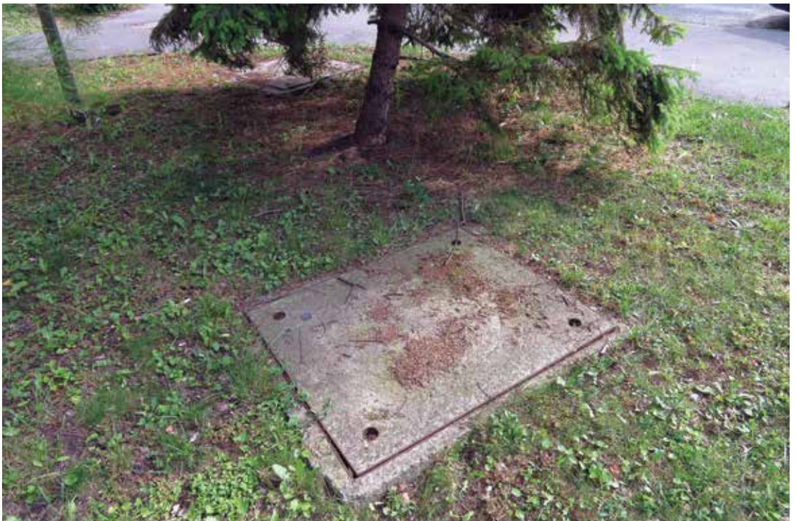
Ryc. 4.1. Drzewo rosnące pomiędzy dwiema studniami telekomunikacyjnymi
